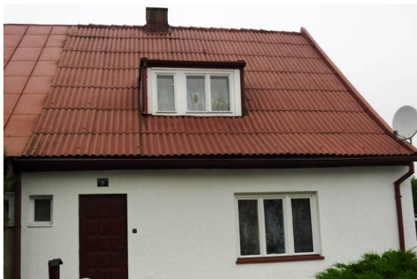
Rys. 6. Pokrycie dachowe ocenione w III stopniu pilności.
