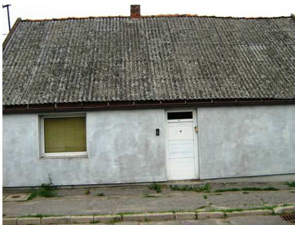
Rys. 7. Pokrycie dachowe ocenione w II stopniu pilności.
