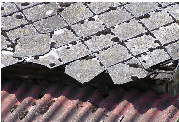
Rys. 8. Pokrycie dachowe ocenione w I stopniu pilności.
